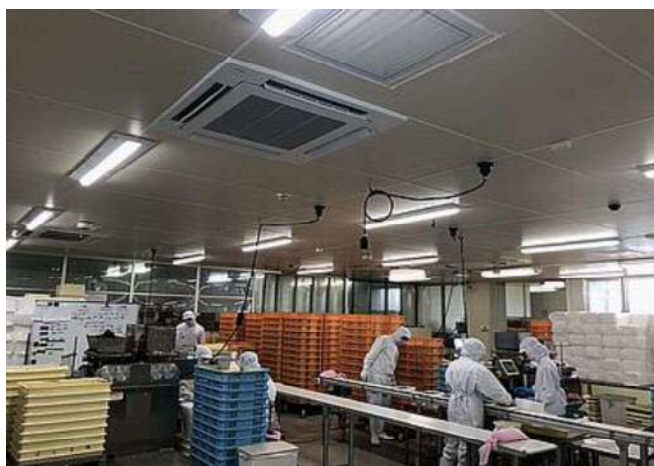
写真：LED 照明導入済みの工場内の照明設備
