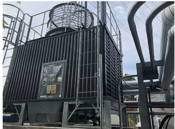
写真：自然冷媒（二酸化炭素/アンモニア）により稼働する冷凍機
